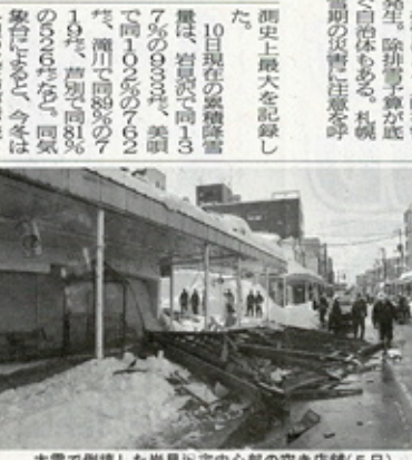
大雪で倒壊した岩見沢市中心的な空き店舗(5日)
