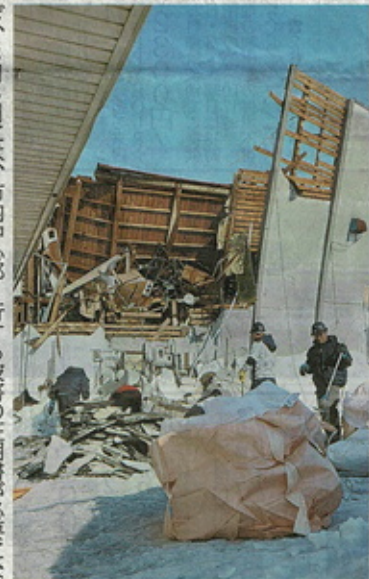
屋根が落ち、壁が崩れ落ちそうになった岩見沢市内中心部の空き店舗。店舗前のがれきが散らばり、周囲は騒然となった。3月5日
